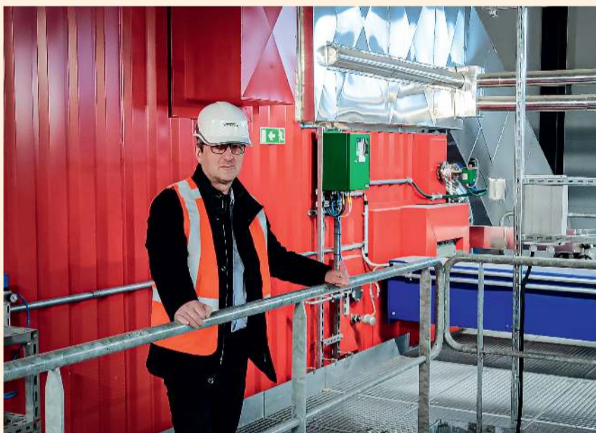
Stefaan Lauwers in de Vyncke-centrale in Säffle: 'Zweden is onze derde installatie die niet-recycleerbaar industrieel afval gebruikt als energiebron.' RV
