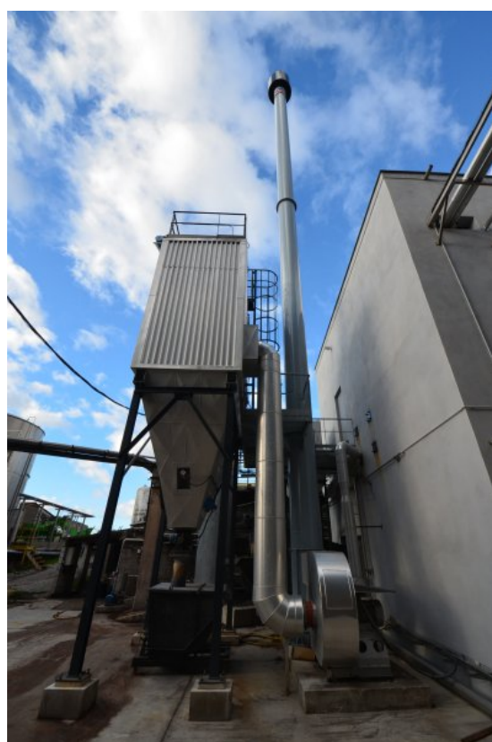
La chaufferie biomasse Bel avec son filtre à manches et sa cheminée BEIRENS, photo FD
