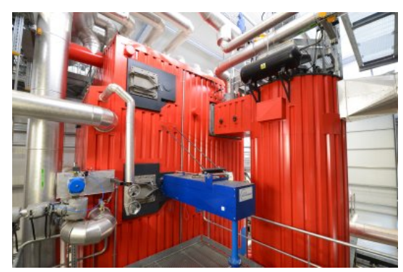
La partie radiative de la chaudière à gauche avec son ramoneur vapeur et l'échangeur à tubes de fumée à droite avec son ramoneur pneumatique, photo FD
